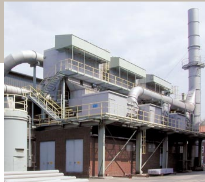
Abgasreinigungsanlage · Dry dust removal plant
